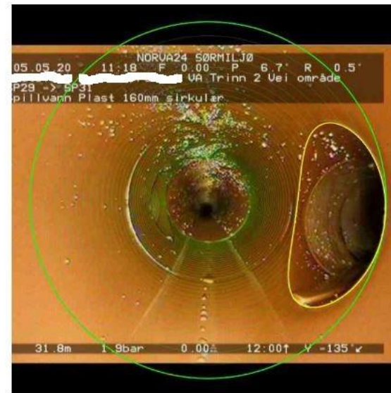
1_200505_103039_62611.jpg, 00:03:40, 38.27m Tilkoblingsfeil 2 Tilkoblingen er plassert med stigende senterlinje (motfall) på 8 Kl.
