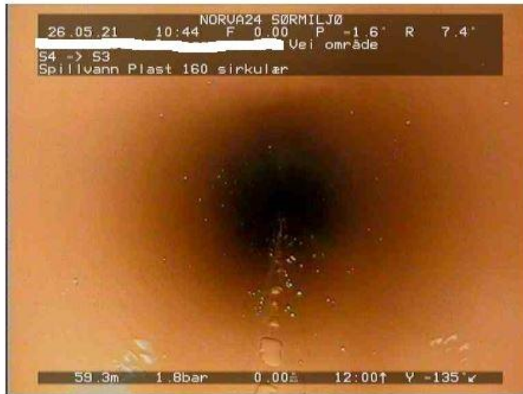
5-1-5A, 00:07:26, 59.58m Deformasjonen er 5 % eller mindre av rørdimensjonen, vertikalt av 6 Kl. til 12 Kl.
